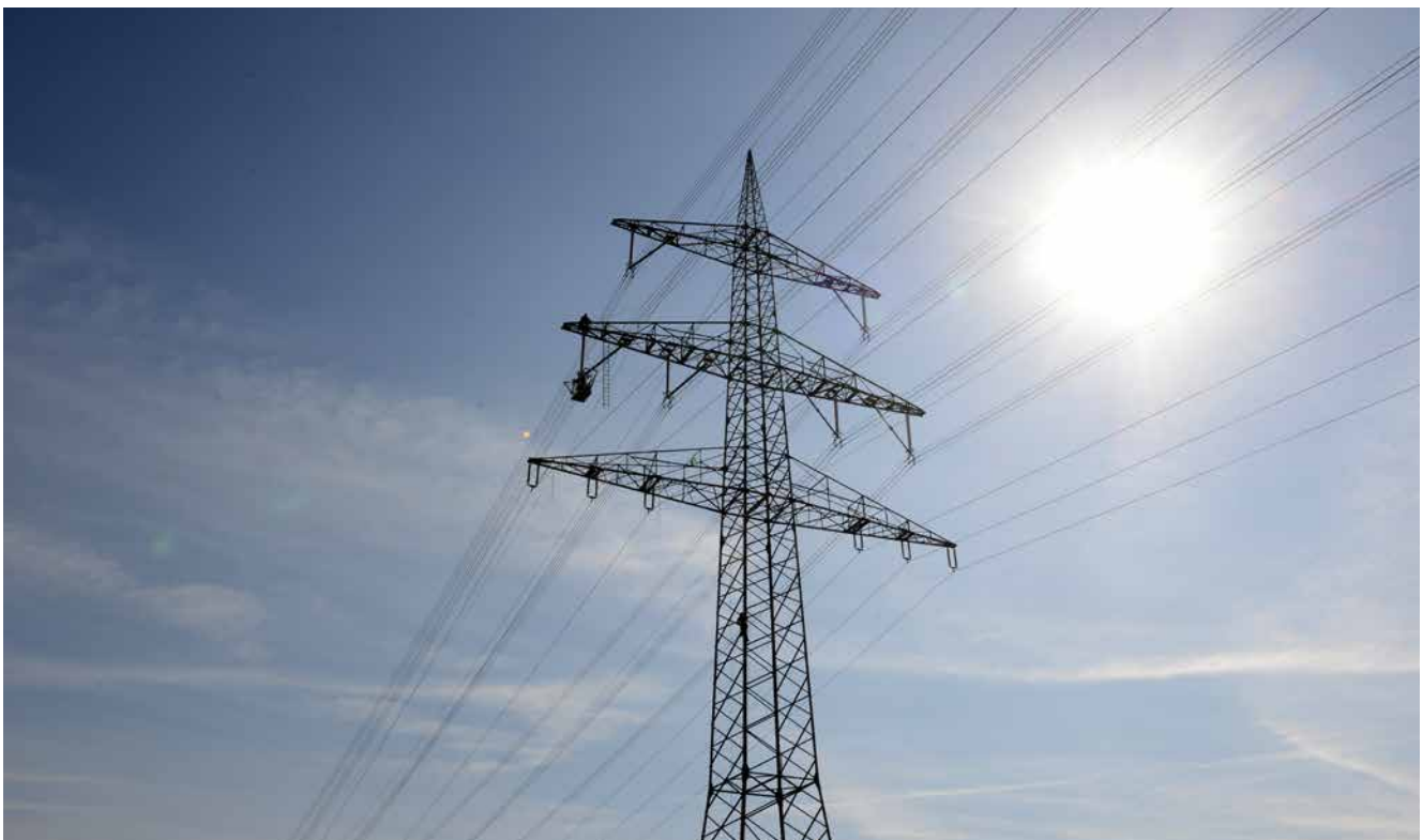
Freileitungs-Strommast im Höchstspannungsnetz.
