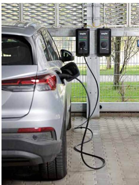
Ladesäulen der SWM.
