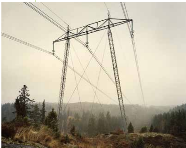
Hochspannungsleitung in Schweden.
